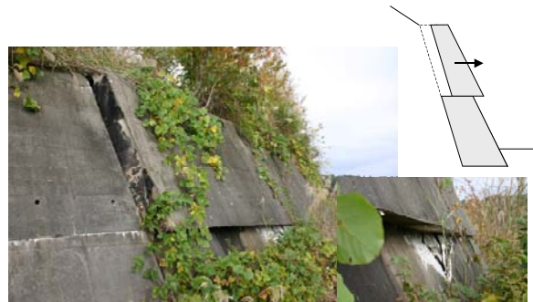
写真 11 重力式擁壁の水平継ぎ目の滑り出し
