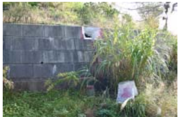
写真6 擁壁から抜け出した間知ブロック
