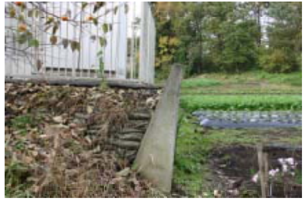
写真 9 傾斜した重力式擁壁
