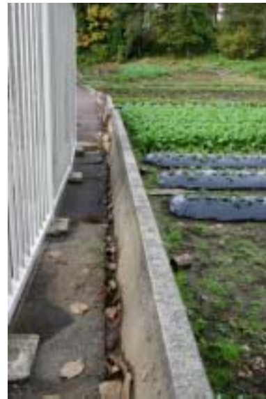
写真 10 盛土地盤の沈下
