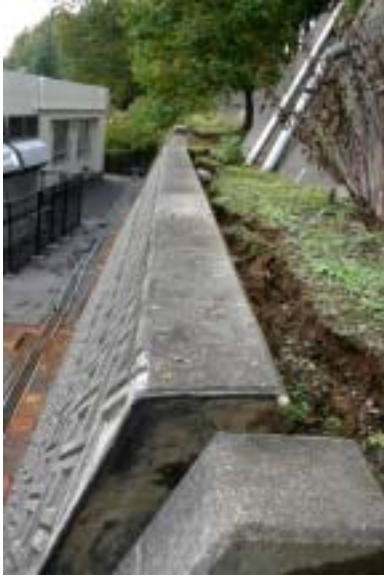
写真 8 長岡市高町の二段積みブロック積み
