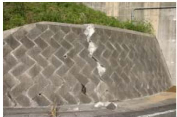
写真4 ブロック積みの鉛直クラック
