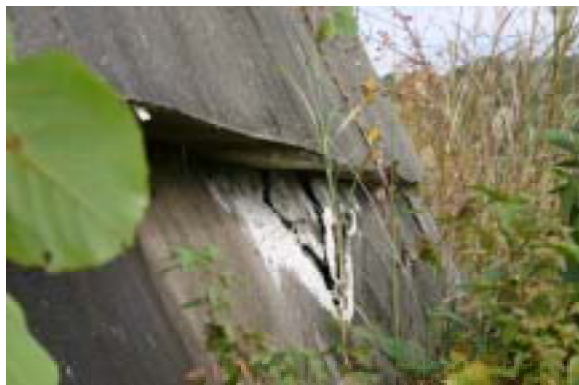
写真 11 水平打継目からのすべり出し
