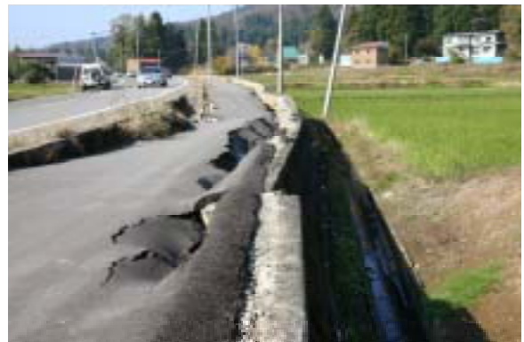
写真7 円弧すべりで変状を生じたブロック積み
