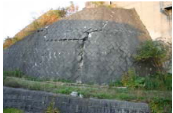
写真5 ブロック積みの縦横方向クラック
