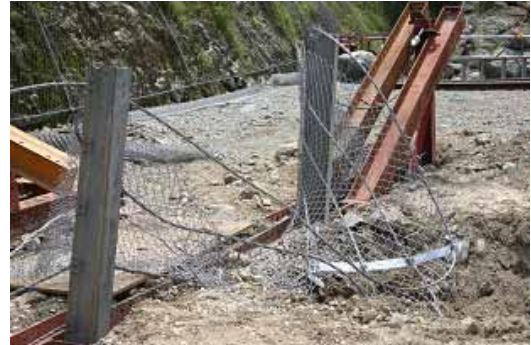
写真 10 破断した防護柵 21)
