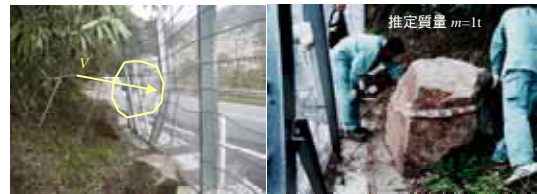
写真5 落石へ防護柵の破損状況と衝突した落石
