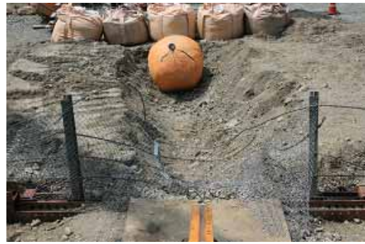
写真 9 コンクリート塊が防護柵を突破 21)
