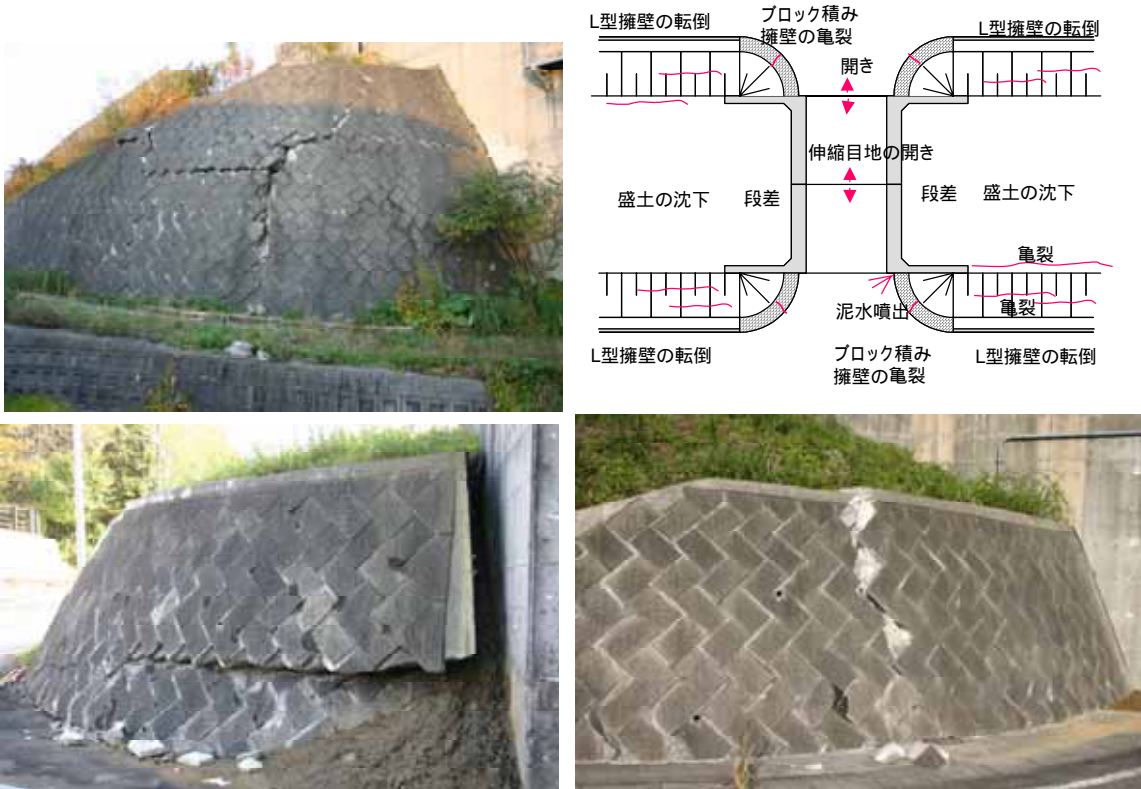
写真-1 平成 16 年新潟県中越地震における関越自動車道の横断函渠の巻き込み部
