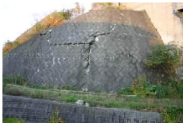
写真 - 4 ブロック積みの縦横方向クラック
