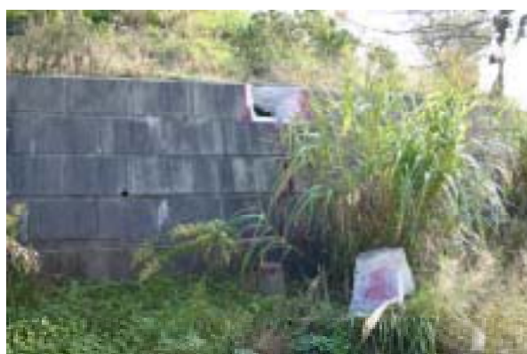
写真 - 6 擁壁から抜け出した間知ブロック
