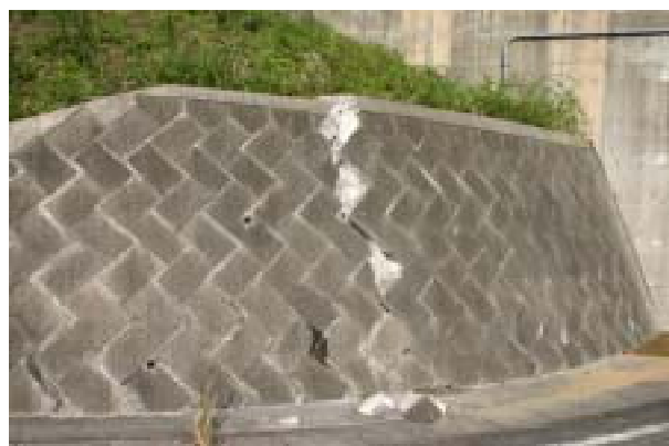
写真 - 3 ブロック積みの鉛直クラック
