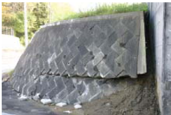
写真 - 5 ブロック積みの水平クラック
