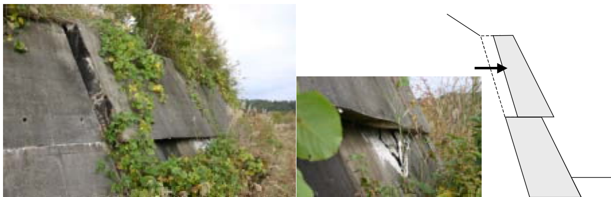
写真 - 10 長岡市高町重力式擁壁の水平継ぎ目の滑り出し
