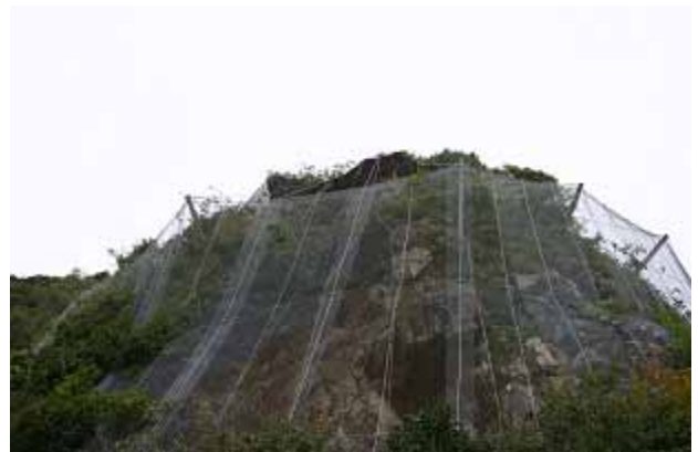
近年に施工されたポケット式ロックネット
